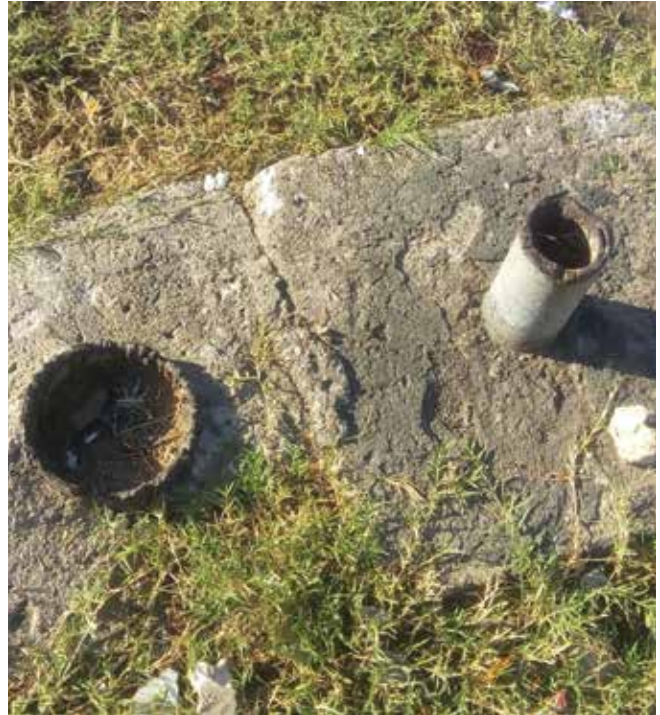
Restos de tubo de metal sobresaliendo 8 pulgadas fuera de la superficie.
